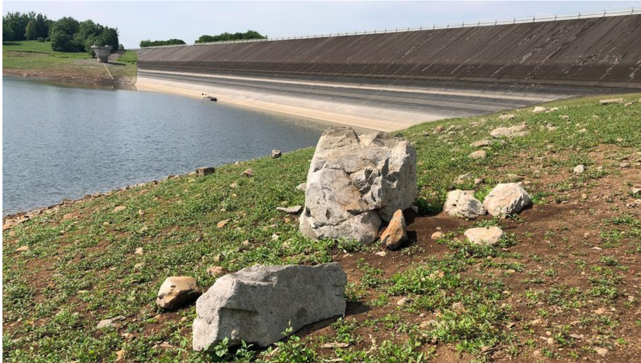
Knapp 50 Jahre alt und sanierungsbedürftig: der Staudamm des Nidda-Stausees Bild © Rainer Battefeld (hr-iNFO)
